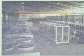
خط انتاج وحدات التبريد المائية (Chillers)
