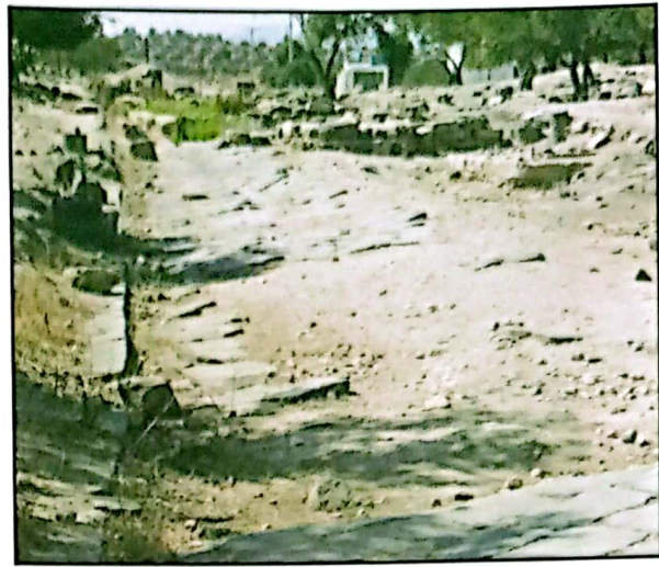
شكل (٣): ظاهرة التميّه (Liquefaction) في شارع الأعمدة في أم قيس.
